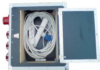
Oprócz swojej pierwotnej funkcji, rozdzielnia spełnia również rolę praktycznego schowka na kable.
